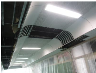
廊下の天井 穴があいてる！
