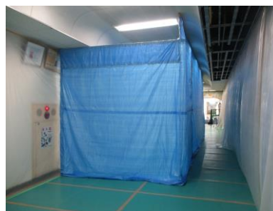
廊下トイレ部分 まるで迷路！
